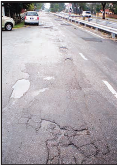
Jalan tidak rata
