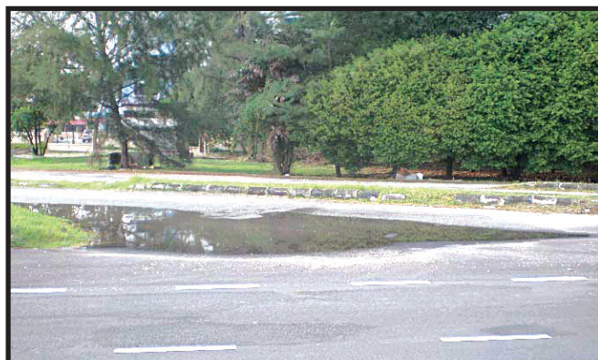
Jalan berlopak yang dilitupi air
