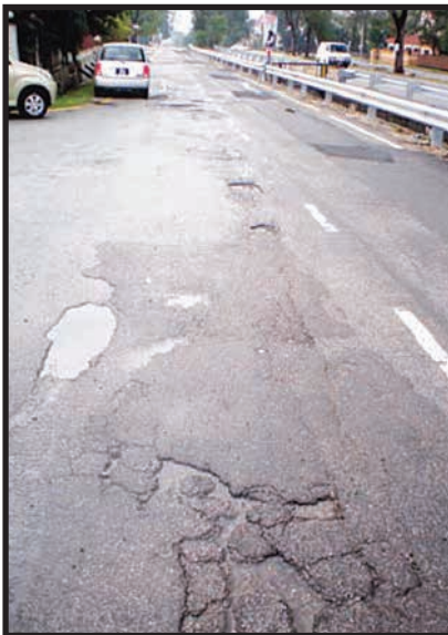
Jalan tidak rata
