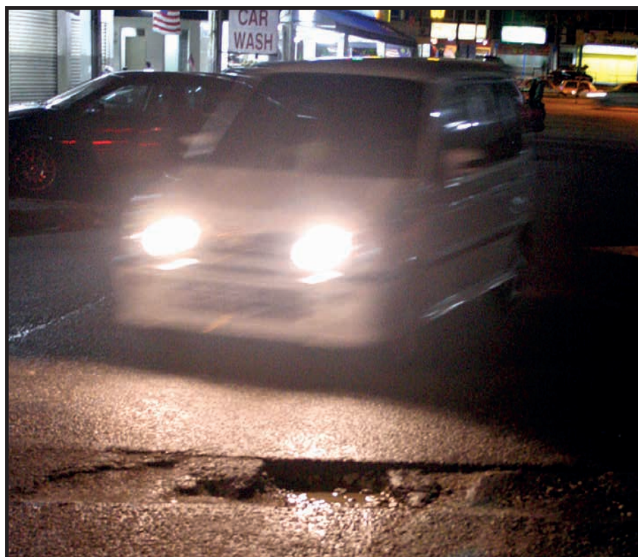
Awasi permukaan jalan yang rosak dan pandu dengan berhati-hati.
