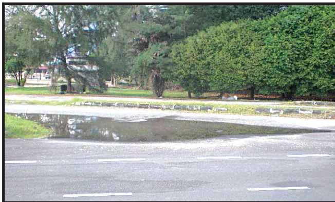
Jalan berlopak yang dilitupi air
